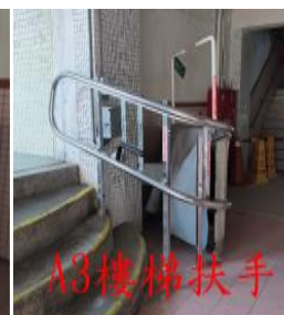
A3樓梯升降設備
